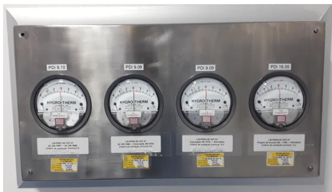
Figura 9 – Foto do painel atual de Magnehelic (QCTG-1027-01).
