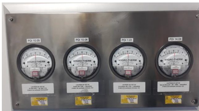
Figura 10 – Foto do painel atual de Magnehelic (QCTG-1027-02).
