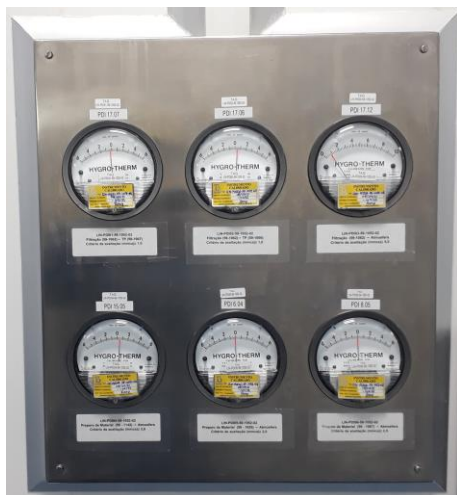
Figura 13 – Foto do painel atual de Magnehelic (QCTG-1052-02).
