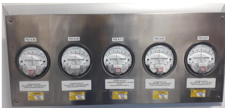
Figura 11 – Foto do painel atual de Magnehelic (QCTG-1027-03).
