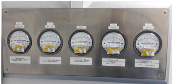
Figura 16 – Foto do painel atual de Magnehelic (QCTG-1133-02).
