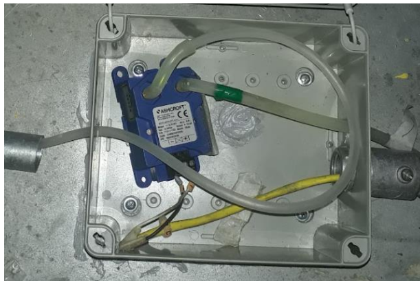
Figura 21 – Imagem de sensor no piso técnico
