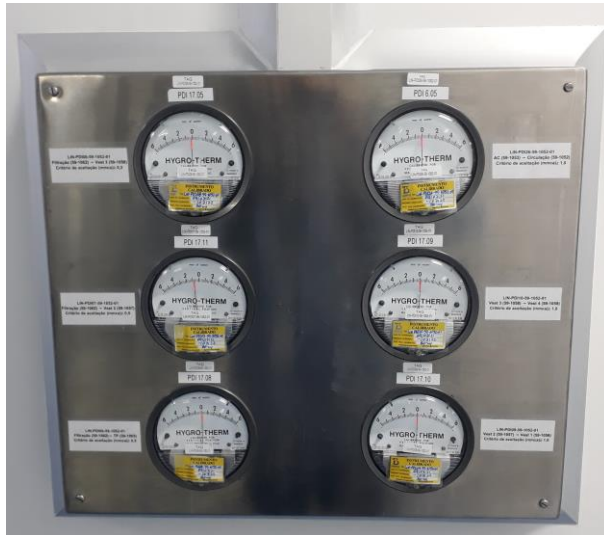
Figura 12 – Foto do painel atual de Magnehelic (QCTG-1052-01).
