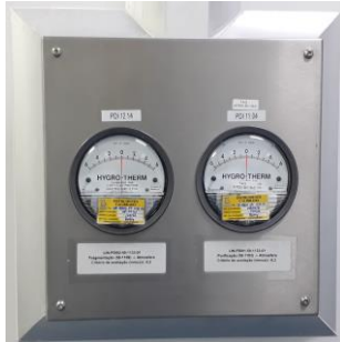
Figura 15 – Foto do painel atual de Magnehelic (QCTG-1133-01).
