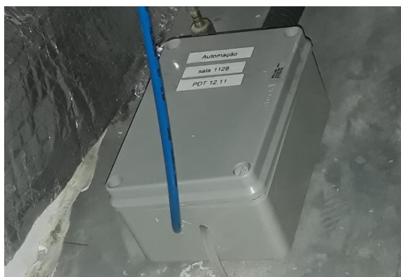
Figura 23 – Imagem da caixa do sensor no piso técnico
