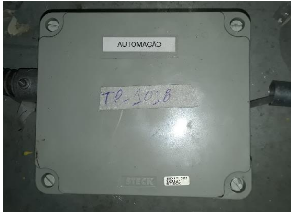
Figura 20 – Imagem da caixa do sensor no piso técnico
