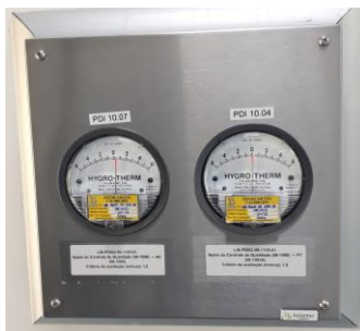
Figura 17 – Foto do painel atual de Magnehelic (QCTG-1135-01).
