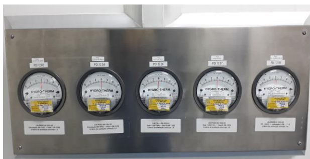
Figura 14 – Foto do painel atual de Magnehelic (QCTG-1052-03).
