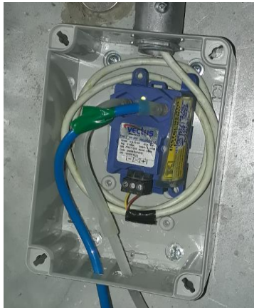
Figura 24 – Imagem de sensor no piso técnico
