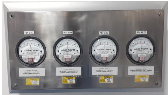
Figura 9 – Foto do painel atual de Magnehelic (QCTG-1027-01).
