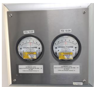
Figura 17 – Foto do painel atual de Magnehelic (QCTG-1135-01).
