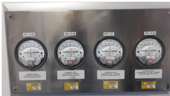
Figura 10 – Foto do painel atual de Magnehelic (QCTG-1027-02).
