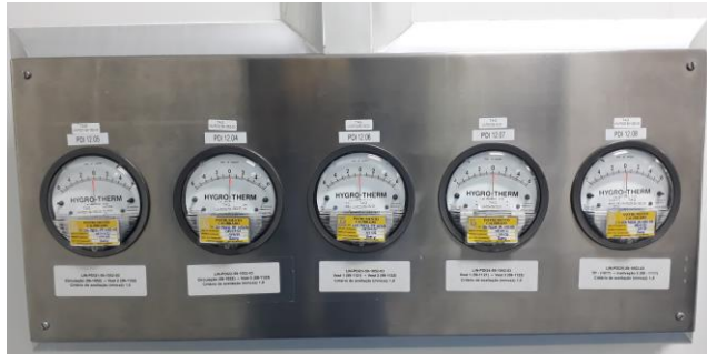
Figura 14 – Foto do painel atual de Magnehelic (QCTG-1052-03).
