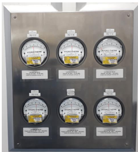
Figura 13 – Foto do painel atual de Magnehelic (QCTG-1052-02).
