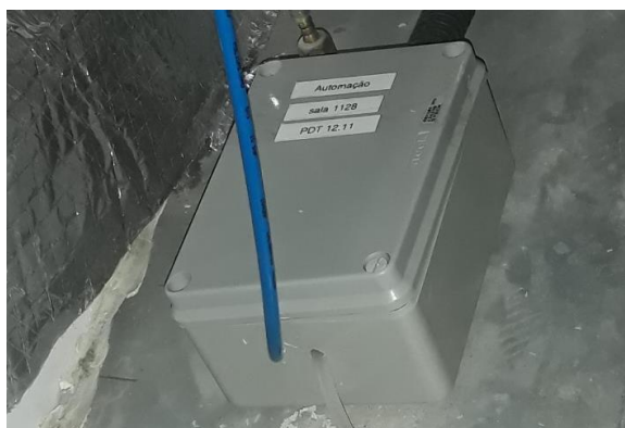
Figura 21 – Imagem da caixa do sensor no piso técnico (Ref. Tabela 2 - Item 2-8)
