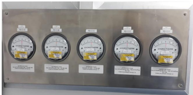
Figura 16 – Foto do painel atual de Magnehelic (QCTG-1133-02).
