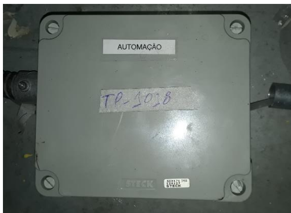
Figura 18 – Imagem da caixa do sensor no piso técnico
