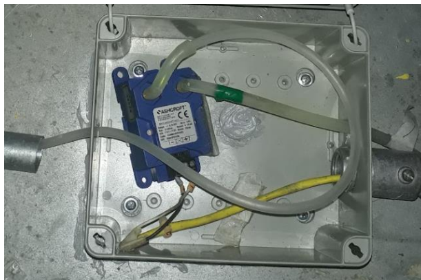
Figura 19 – Imagem de sensor no piso técnico
