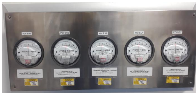
Figura 11 – Foto do painel atual de Magnehelic (QCTG-1027-03).
