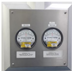
Figura 15 – Foto do painel atual de Magnehelic (QCTG-1133-01).
