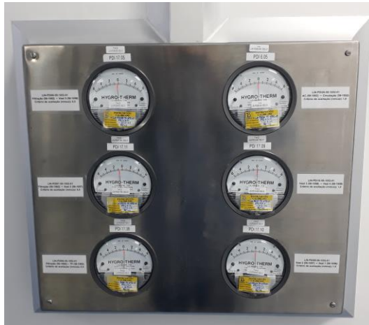
Figura 12 – Foto do painel atual de Magnehelic (QCTG-1052-01).
