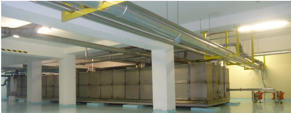
Figura 1 – Tanque de armazenamento de Efluentes Líquidos de 30.000L
