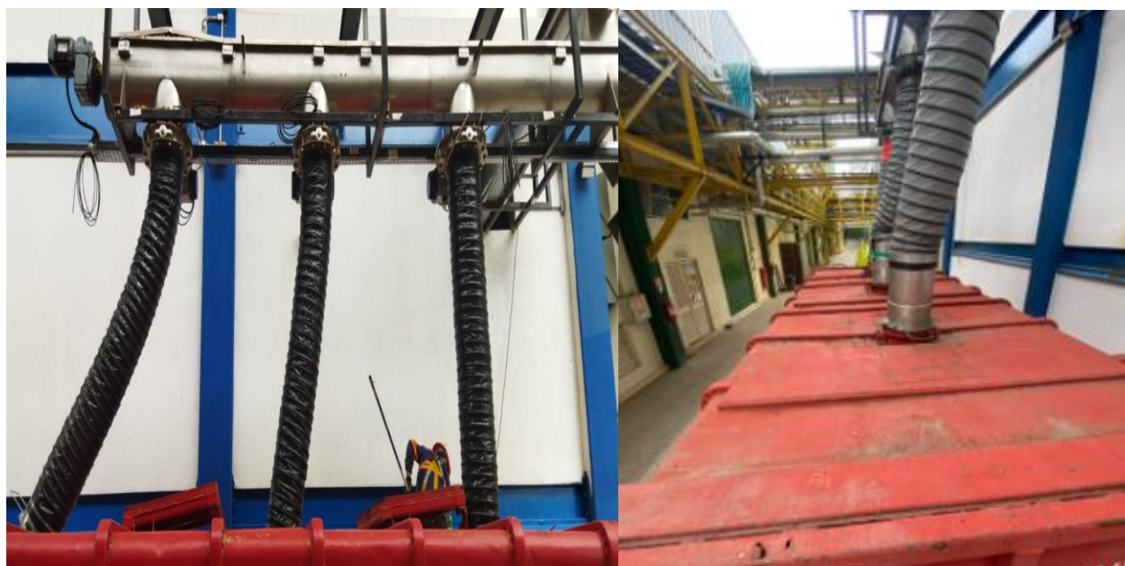
Figura 2: Visão geral do sistema de descarte por roscas transportadoras e válvulas pneumáticas em caçamba rollon.
