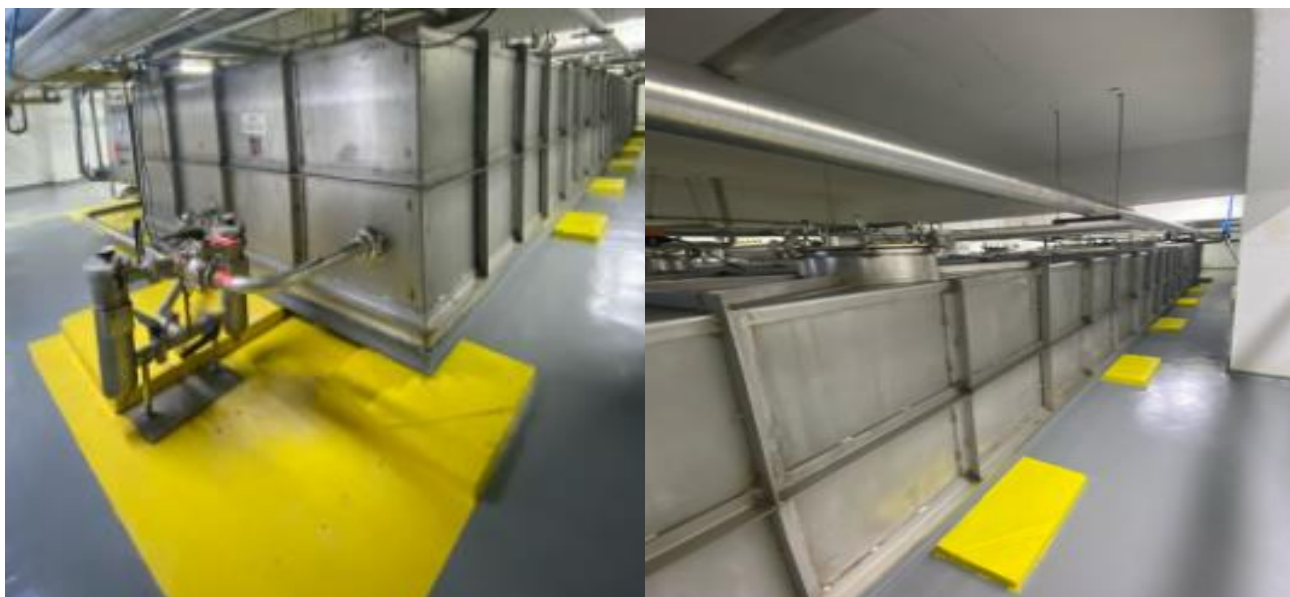
Figura 1: Visão geral do tanque de 30.000L
